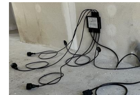
Voorbeeld keukenverdeler met aangesloten kabels
