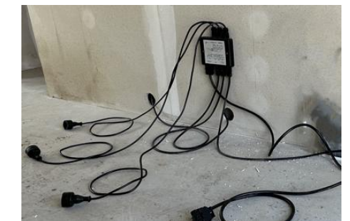
Voorbeeld keukenverdeler met aangesloten kabels
